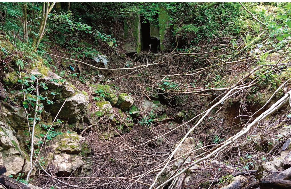
Fig 8. La dépression rocheuse du Tournant (538-004) située en contrebas d'une conduite bétonnée peut y déverser d'importants volumes d'eau.
