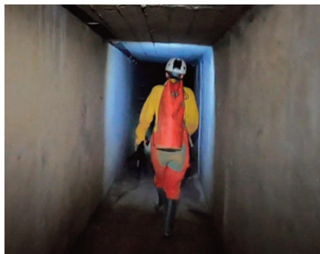
Fig.3. Inspection de l'état du pertuis principal (en amont du village) après la crue (Photo Joel Hosselet).
