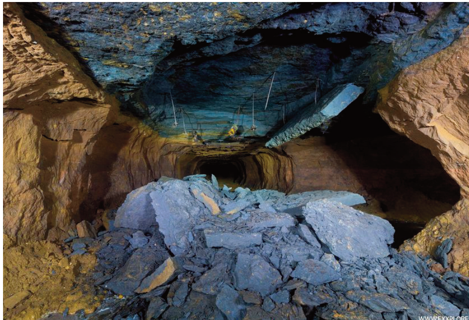
Fig. 4. Effondrement partiel et état inquiétant de la voûte de certaines galeries de la mine d'Halanzy (photo Tchorski - V. Duseigne).
