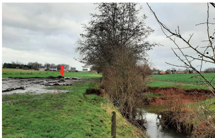
Fig. 7. Affaissement ouvert brutalement quelques jours après le forage du piézomètre (flèche rouge). Photo 23/12/2023, SWDE - Point C/
