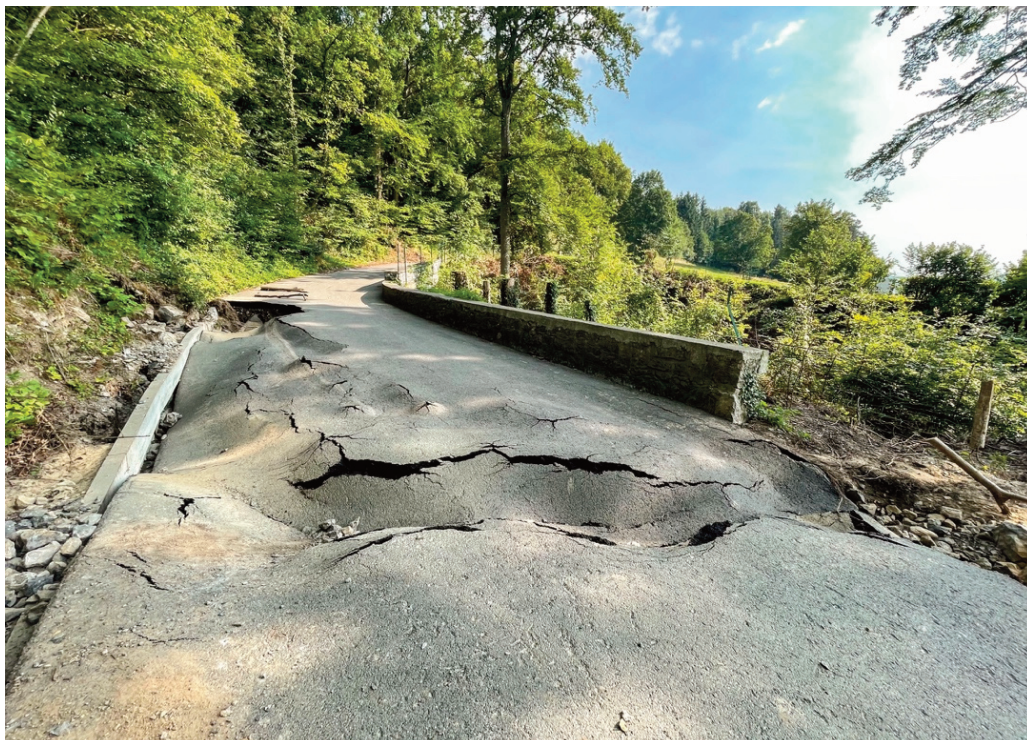
Photo 5: A la mi-juillet 21, après la décrue le spectacle des dégâts dus à la force de l'eau.
