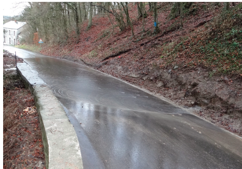
Photo 3 : moins de trois mois après les travaux de l'eau sort au pied du talus inondant la chaussée qui surplombe la résurgence de plusieurs mètres (ph. R. Cordier).
