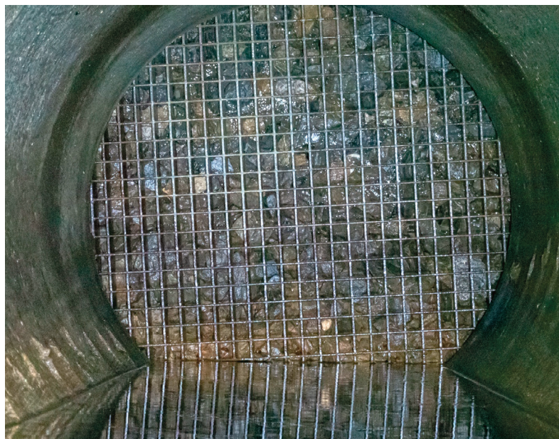
Photo 6. Au bout du conduit une grille retient des cailloux, tous du même calibre, ce qui montre bien qu'il s'agit du remplissage réalisé lors des travaux de réfection de septembre 2012.
