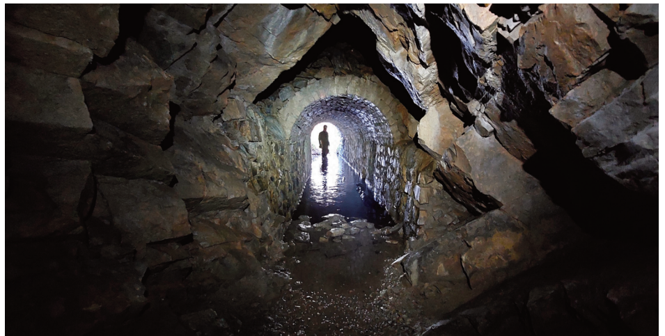
Fig05. Passé les 10 premiers m depuis l'entrée, qui sont appareillés en moellons et briques, la galerie est directement creusée dans les grès de teinte jaune à ocre. Un très faible écoulement (quelques l par minute) s'épanche au sol, provenant essentiellement de la percolation au travers de la voûte (photo FP)
