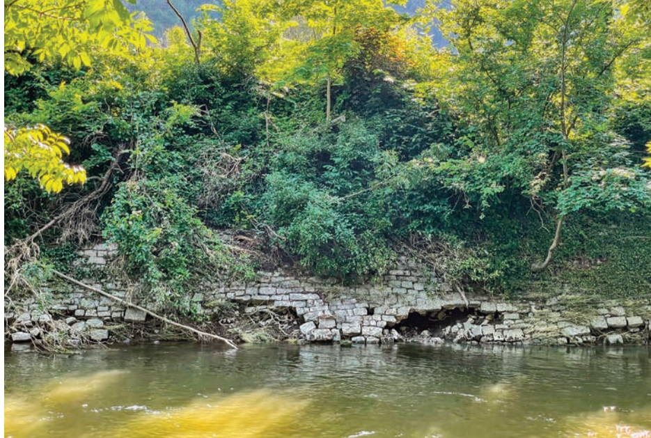
Photo 4. Le mur de soutènement de la route malmené par la crue. Le trou à droite surplombe la résurgence de la grotte de Hotton. Il s'est nettement agrandi suite au coup d'eau.
