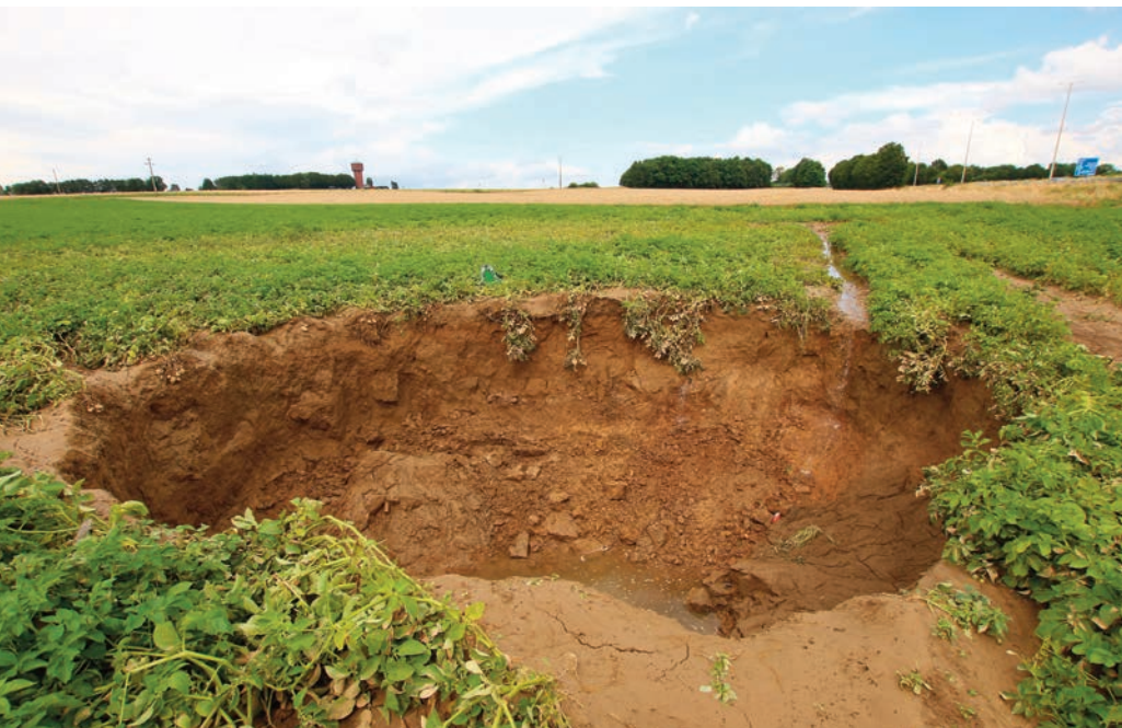
Fig. 9. Suite aux inondations du 22 juillet 2021 à Emines (La Bruyère), un effondrement s'est brusquement ouvert dans un champ à moins de 50 m de l'autoroute E42. Les eaux de ruissellement de la voie rapide et du caniveau y sont absorbés vers le sous-sol calcaire.
