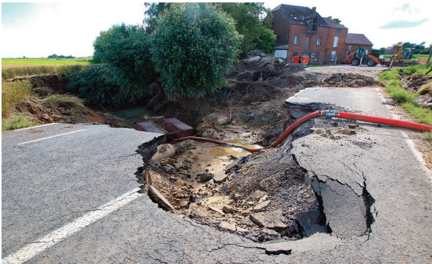
Fig. 15. Le vaste effondrement de Neufvilles (Soignies) s'est ouvert à la fin du mois de juin 2021, après de très fortes pluies. Cet apport d'eau massif, a engendré un soutirage qui, à son tour, a provoqué la rupture de 2 canalisations d'eau. Le karst sous-jacent a été vidé de son remplissage, aboutissant à l'effondrement de la route et à la formation d'un fontis atteignant 50 m de long.
