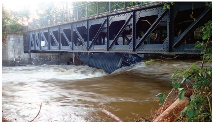
Fig. 2. Container coincé au pont du RAVeL, qui a fonctionné comme un barrage, provoquant une hausse locale des eaux et entraînant la destruction de la berge et de la digue.
