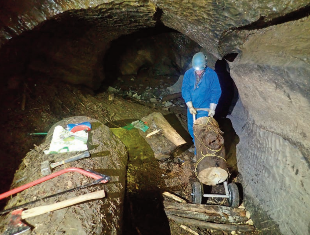
Fig. 5. Nettoyage et dégagement de la grille du Nou Maulin (Rochefort) des déchets et encombrants flottés apportés par les crues. Cet entretien régulier, réalisé par les spéléos, permet non seulement de maintenir l'accès au réseau spéléologique, mais aussi d'assurer de bonnes capacités d'absorption à ce chantoir proche de la Lomme (photo Marc Legros).
