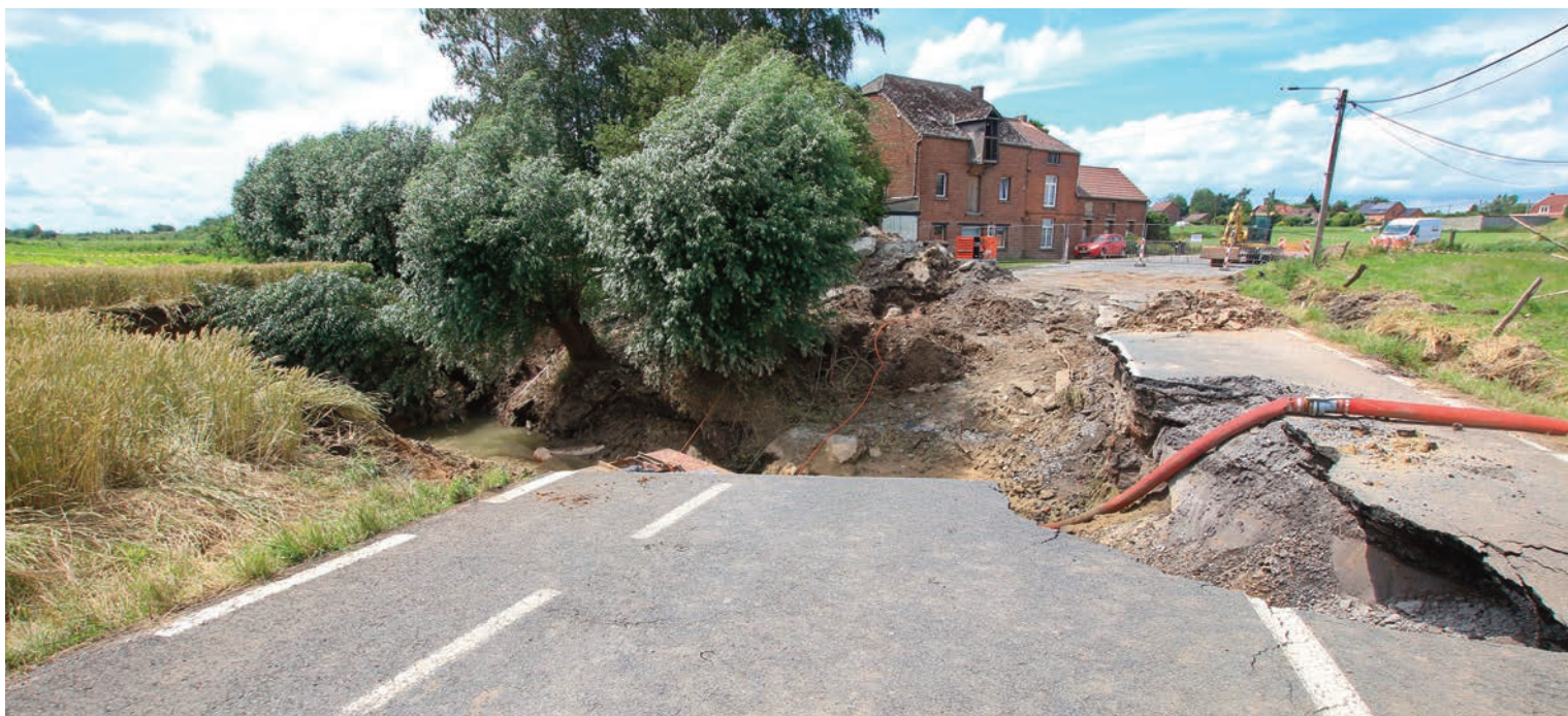
Fig. 3. Vue générale de l'effondrement principal (n° 4) depuis l'axe de la route nationale (côté sud). À l'arrière-plan, le bâtiment en briques correspond au n°13 de la rue de Montignies (photo CWEPPS 08/07/2021).
