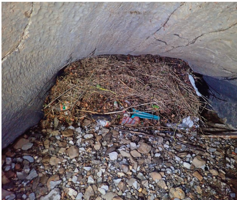
Fig. 14. La grille du Nou Maulin (Rochefort) couverte de déchets et d'éléments flottés apportés par la Lomme en crue qui se déverse dans la grotte. Cette situation se répète après chaque période de hautes eaux, imposant un nettoyage systématique (photo M. Legros).
