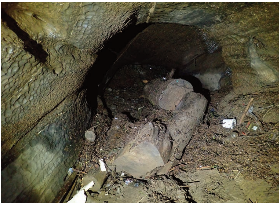
Fig. 5. Les grumes de bois et bien d'autres matériaux qui avaient été entreposés près des berges de la Lomme ont été emportés par les crues. On en retrouve une partie, coincée sur la grille du Nou Maulin, qui a évité un colmatage du réseau plus profond.
