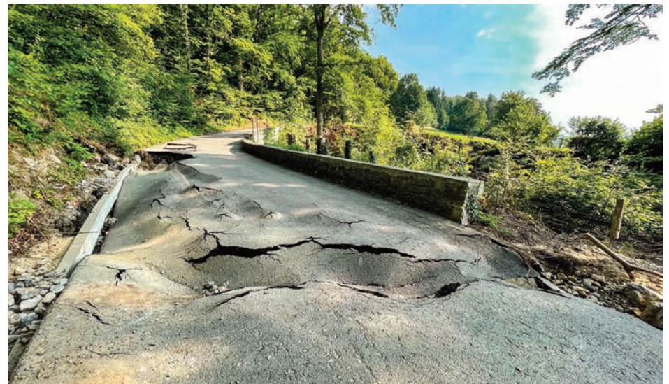
Photo 7. L'état de la route passant au-dessus du drain karstique alimentant la résurgence de Soy, quelques jours plus tard lorsque les eaux ont cessé de couler.
