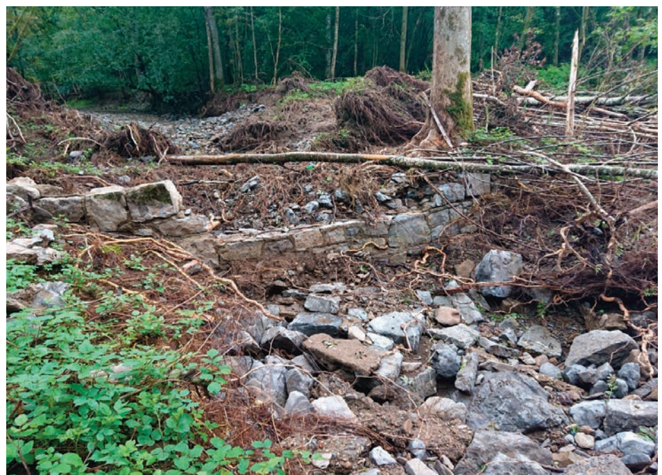
Photo 3. Le nouveau lit de la Lembrée creusé par la crue (l'ancien lit se trouve en arrière-plan). Photo P. De Bie.
