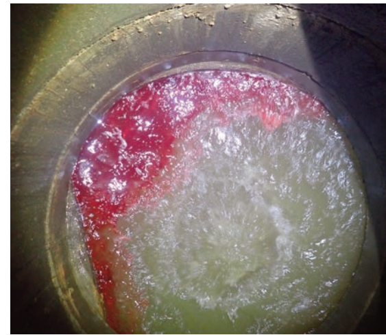
Fig. 4. Hydrocarbures visibles dans le collecteur de la rue de France, dont le trop-plein est évacué vers le bien nommé « Trou de l'Égout ».
