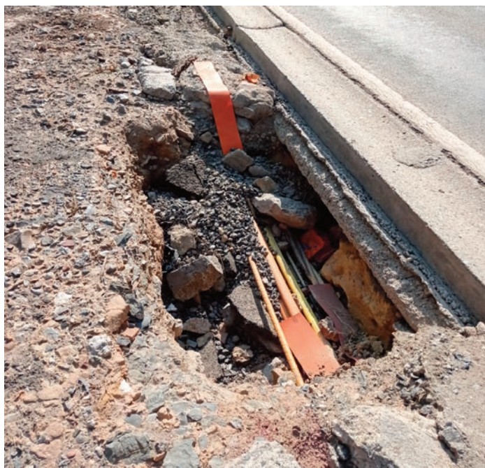
Photo 8. A l'aval du viaduc, le flux de la crue a décapé le sol et arraché le tarmac sur plusieurs dizaines de cm d'épaisseur.
