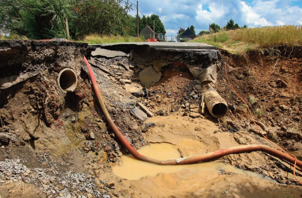
Fig. 4. L'effondrement a recoupé deux canalisations. Celle de gauche permettait à l'eau du ruisseau de franchir la route. Celle de droite (parallèle à la route) est une conduite d'adduction d'eau de la SWDE.
