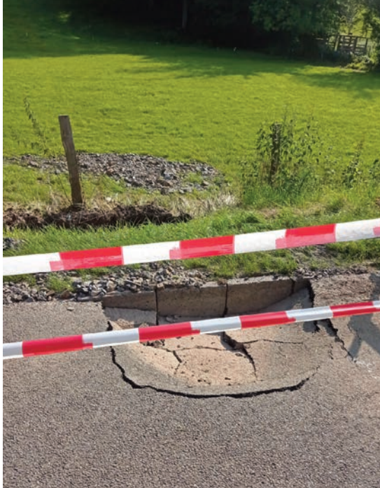
Photo 5. La pression exercée par les eaux aboutissant à la résurgence principale de Playe fut telle que les cailloux qui la remblaient ont été projetés sur plusieurs mètres et que la route s'est soulevée pour ensuite s'affaisser au moment de la décrue.
