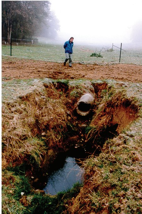
Surcreusement du lit de la Noire Fontaine à l'aval des zones canalisées où se forment de petites chutes d'eau (photo 2003).
