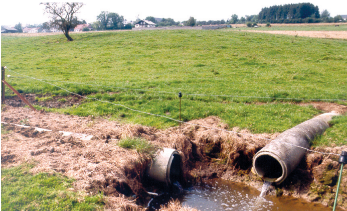
Les deux conduites d'eaux usées aboutissent dans une pâture, au nord de la route nationale (photo 2003).
