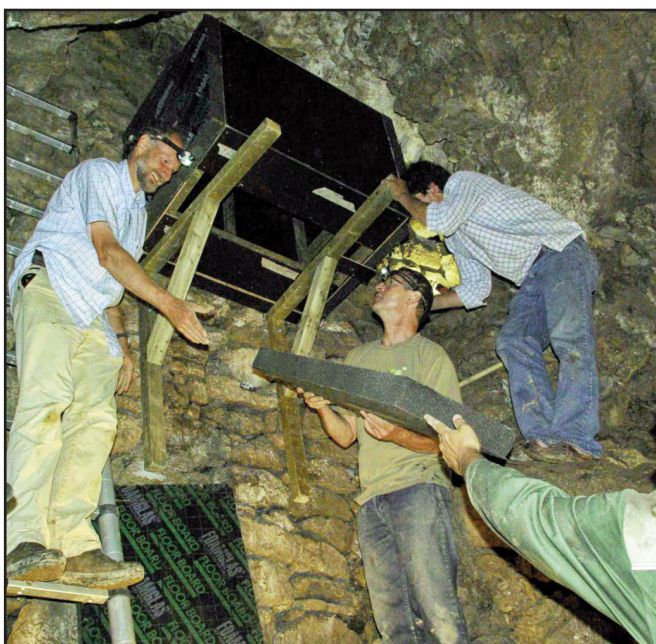
Installation de la Hot Box dans les plafonds de la grotte (travaux réalisés par Plecotus)
