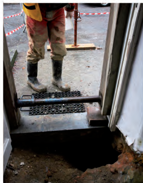
Demande d'avis suite à la découverte d'un effondrement sous une maison à Nismes (Viroinval).
