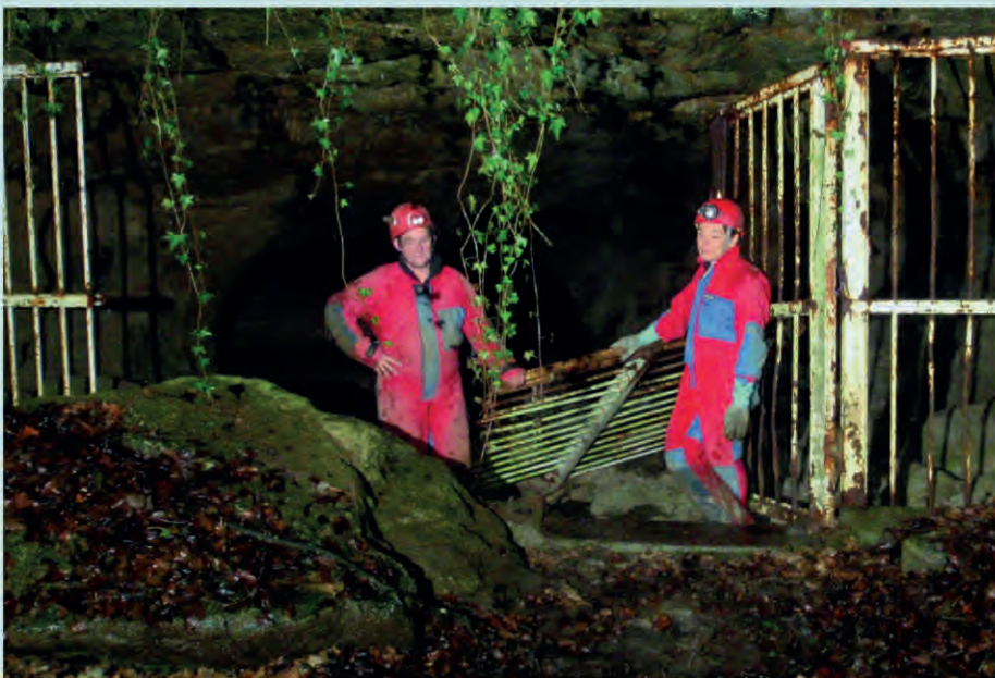
État de la grille censée protéger la cavité — situation en 2011 (photo G. Fanuel).
