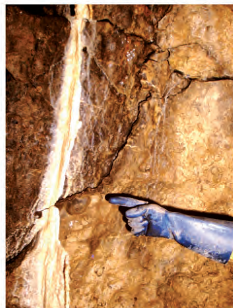
Concrétions fissurées suite aux tirs à Hotton (photo 1978 - (photo J.-P. Bartholeyns).
