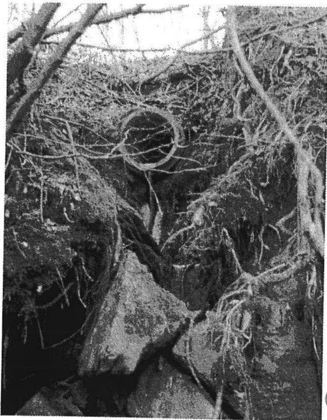
Rejet d'eaux usées dans le chantoir Ghesquière
